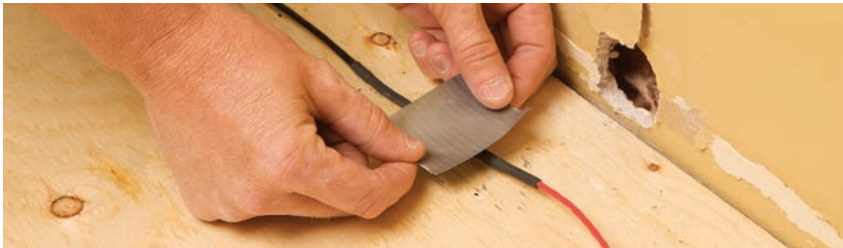
FIGURE 2.23 : Fixer le conducteur froid au faux plancher
