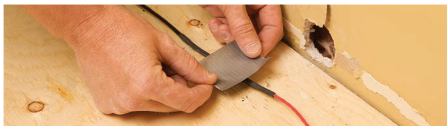
Figure 2.2.3 : Fixer le conducteur froid au faux plancher
